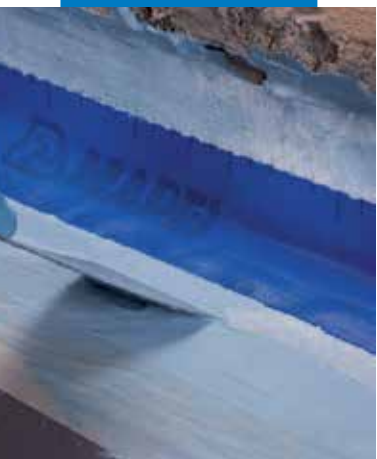
A Mapeband helyére ragasztása Mapelastíc AquaDefense-vel fal és padló vízszintes és függőleges felületei között
