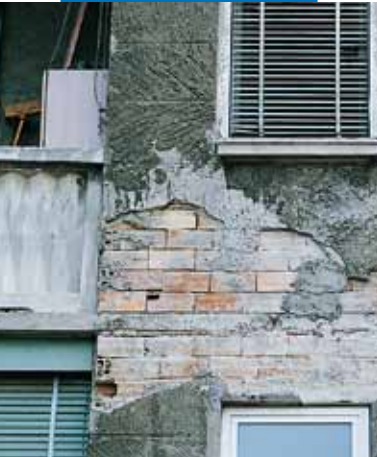
Javítást igénylő, károsodott épülethomlokzat
