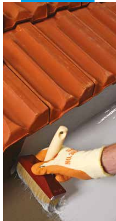
Példa Mapelastic Smart-tal vízszigetelt Elastocolor Waterproof-fal bevont ereszcatornára
